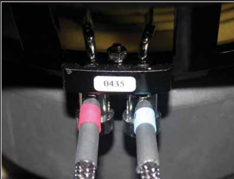
▼ Myös kaiuttimien päässä kaapelit on koodattu värien mukaan.
